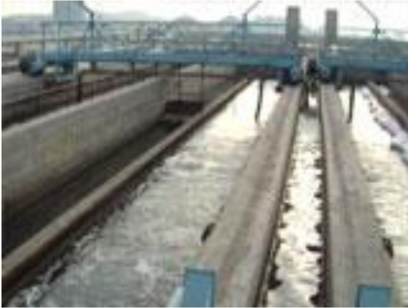
Décanteur à flux horizontal
